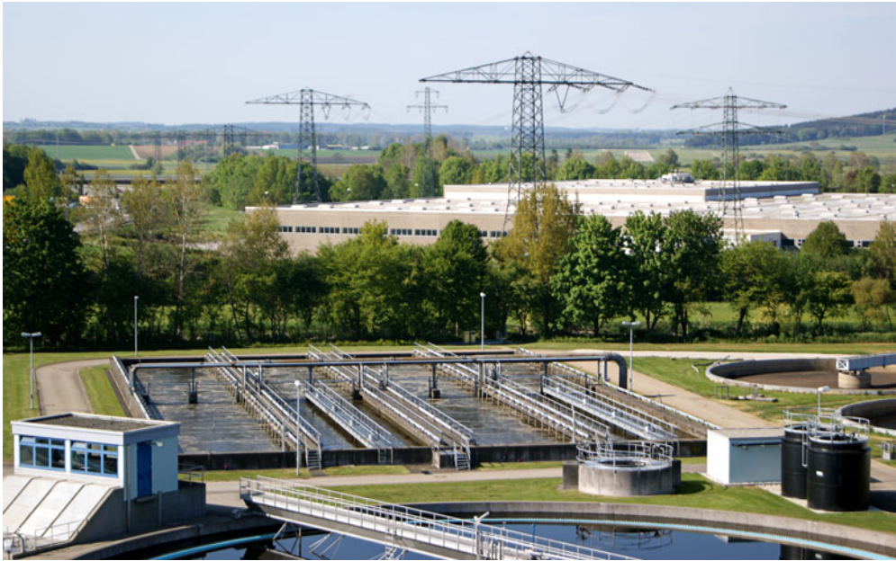
Blick über die Belebungsbecken
