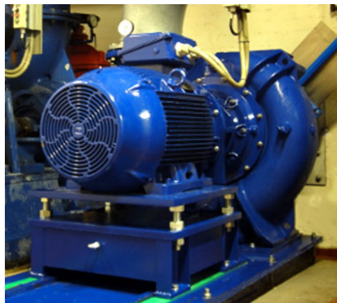
Eine der sechs Abwasserpumpen
